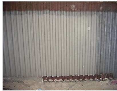
【整備後のボイラ水管】
