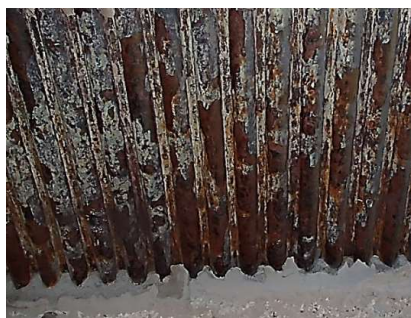
【整備前のボイラ水管】
