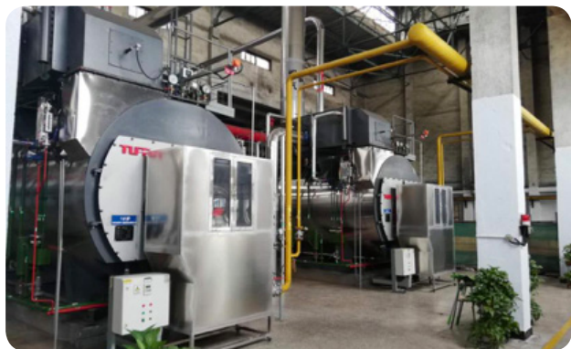
航空工业沈飞新建两台 10 吨燃气炉 2020 年已正常投入使用，显著降低了氮氧化物和硫化物排放。
