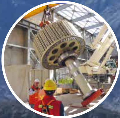
SALA DE MÁQUINAS DOS TURBINAS FRANCIS DE 35 MW
