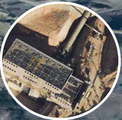
SALA DE MÁQUINAS DOS TURBINAS FRANCIS DE 31,64 MW
