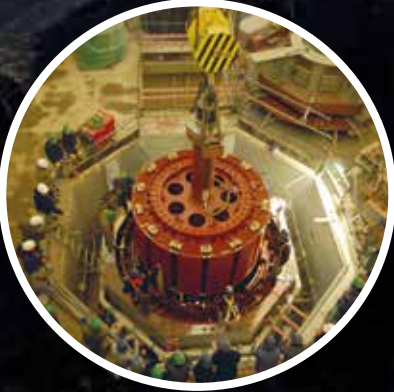
SALA DE MÁQUINAS DOS TURBINAS TIPO FRANCIS DE 62,5 MW CADA UNA
